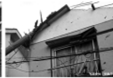
倒れた電柱で壊れた家
