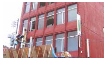
破损、掉落的窗户玻璃
