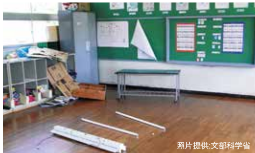
掉落的日光灯
