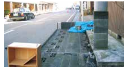
Muro de bloco tombado
