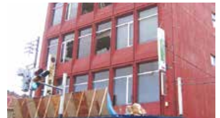
Queda dos vidros quebrados da janela
