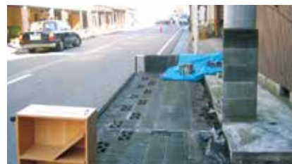
倒れたブロック塀
