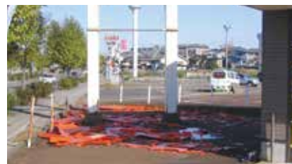
落下した屋外看板
