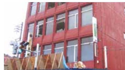
破損、落下した窓ガラス
