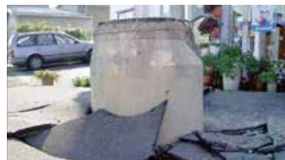
突き出したマンホール
