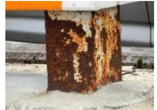
支柱根元の腐食が進行した状態
