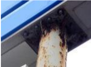
接合部（溶接部）が腐食している状態
