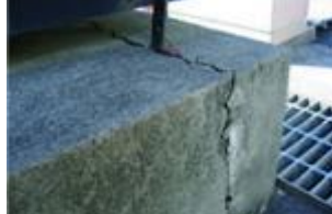
基礎にクラックが入った状態
