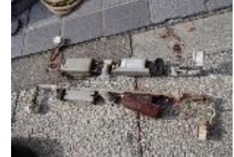
変圧器（トランス）のさびが進行した状態
