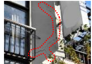
壁面にひびが生じた状態
