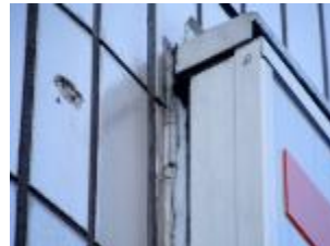
コーキングが劣化した状態
