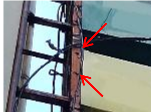
ボルトのゆるみや欠落した状態
