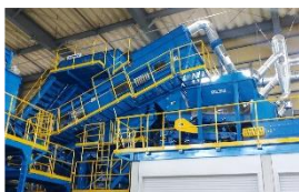
プラスチック高度選別設備
