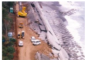
井田地区海岸平成9（1997）年被災状況
