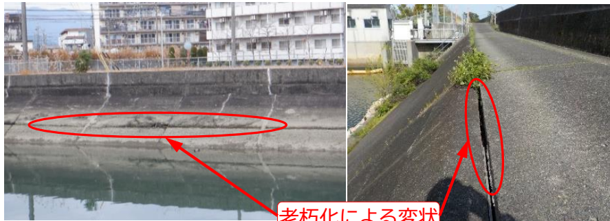
老朽化による変状
