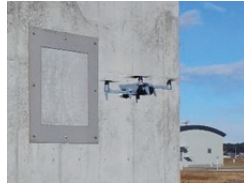
ドローンによる損傷把握
