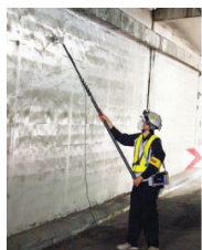
点検者から離れた位置を打撃し、打撃波形から打音異常を判定
