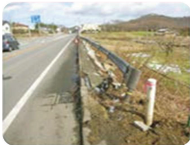
ガードレール・ 標識等の損傷
