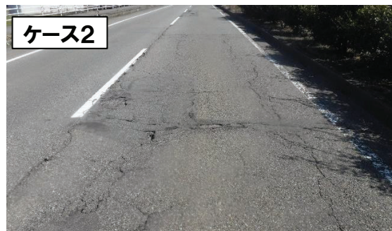
50年以上経過し、数度の表層修繕を経験
