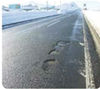
路面の穴ぼこ・ 段差
