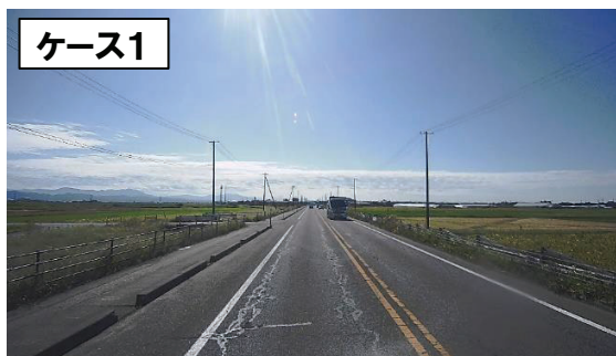
圃場部のバイパス等で早期劣化を確認
