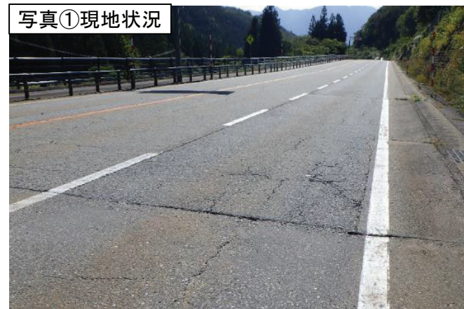
写真②現地状況(ひび割れ)
