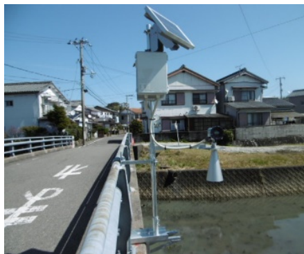
危機管理型水位計 （三重県）
