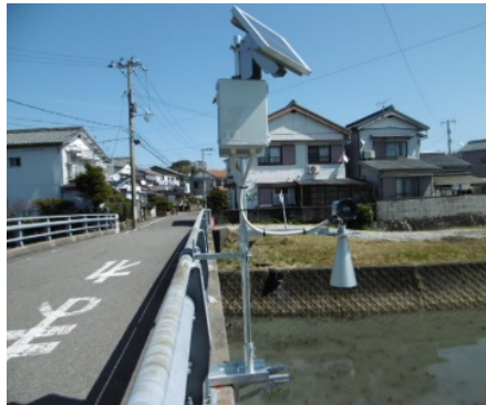
危機管理型水位計 （三重県）
