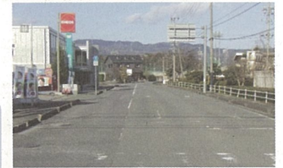
交差点部区画線の劣化状況
