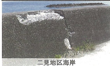
波浪による劣化箇所の剥離
