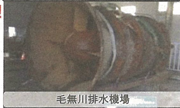
老朽化する河川管理施設
