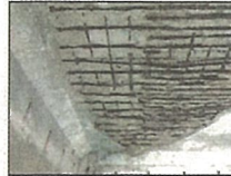
津松阪港-7.5m大口岸壁 岸壁上部工老朽化状況
