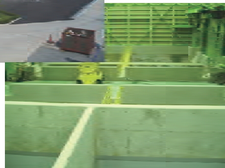
RDF貯蔵ピット
