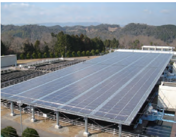
【太陽光発電設備(高野浄水場)】
