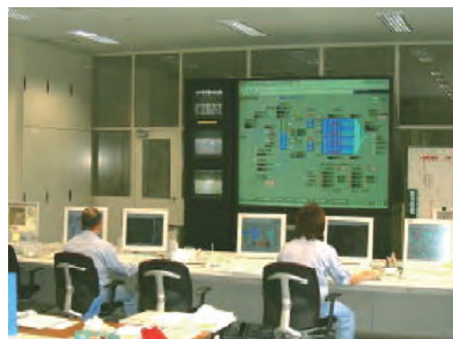
民間業者による運転監視
