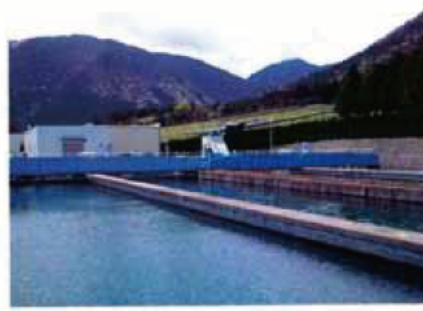
沈でん池（北中勢水道 水沢浄水場）
