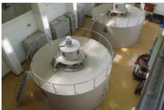
発電機(宮川第二発電所)
