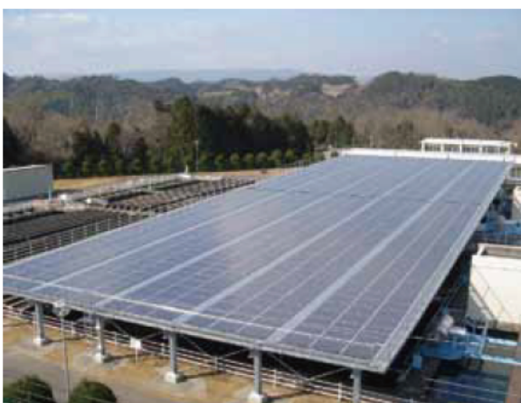
【太陽光発電設備(高野浄水場)】
