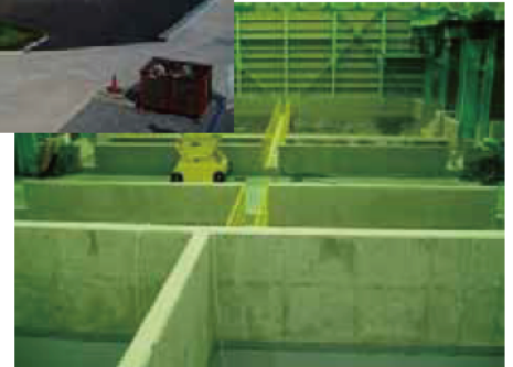
RDF貯蔵ピット
